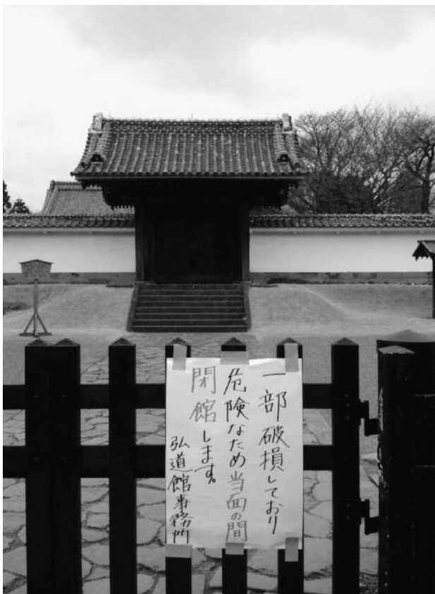
水戸市弘道館も一部損壊し閉鎖中
