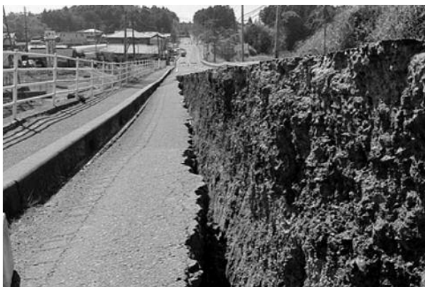
那珂市額田 349号線の地割れ
